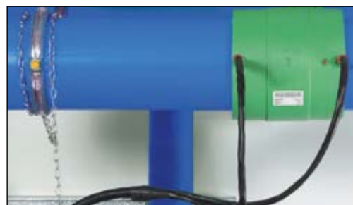
Still sveisemaskinen på riktig dimensjon. Start sveisingen og overvåk hele prosessen. Overhold avkjølingstiden.
