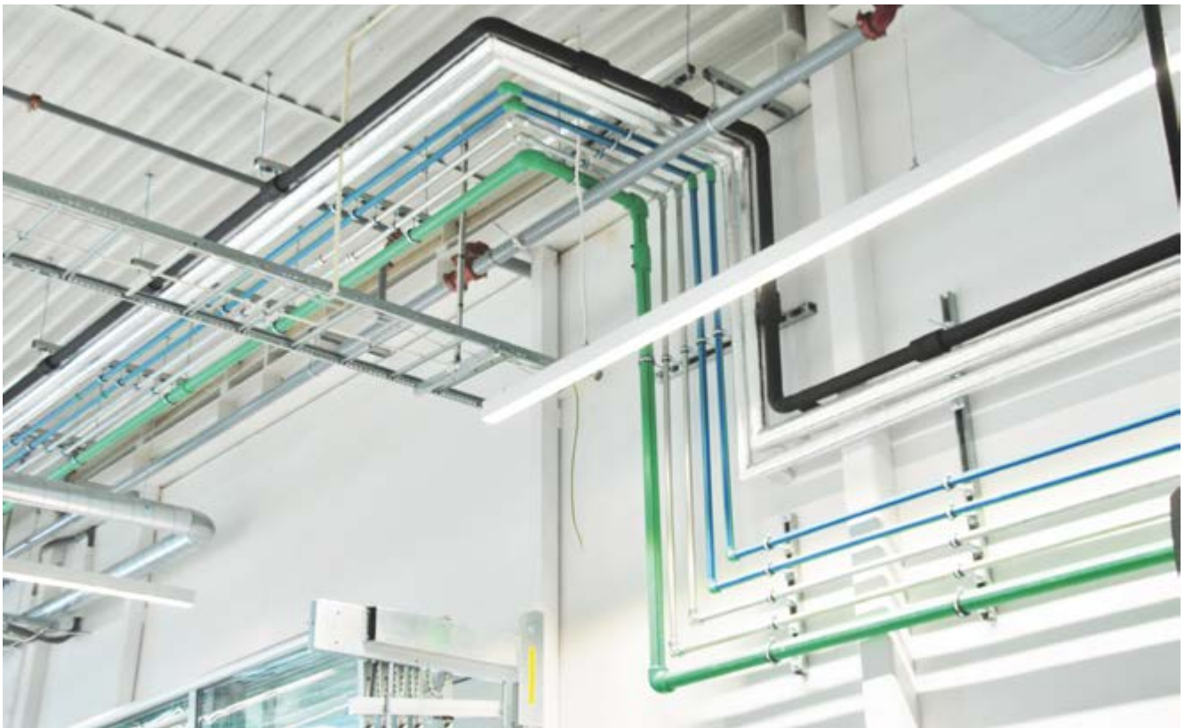
Aquatherm green pipe- og blue pipe rør.
