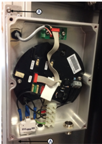
Rysunek 36: Skrzynka elektroniki w obudowie znaku
