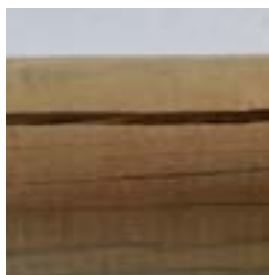
Cracks/Grietas/Fente/Risse/ Crepe/ Barsten/Fendas
