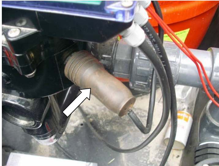
Fig. 26.- Presostato de la válvula Basic con su funda protectora.
