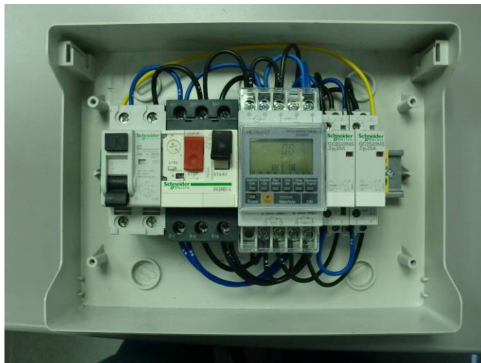
Fig. 12.- Armario de maniobra para bomba DUAL SPEED
