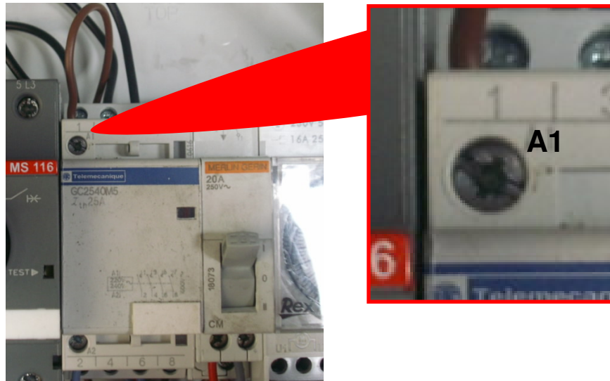
Fig. 8.- Localizar borne A1 en el contactor de la bomba.
