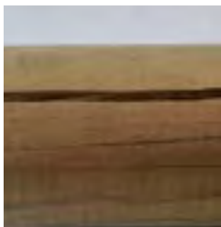
Cracks/Grietas/Fente/Risse/ Crepe/ Barsten/Fendas
