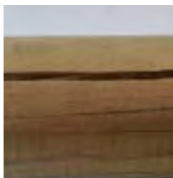
Cracks/Grietas/Fente/Risse/ Crepe/ Barsten/Fendas
