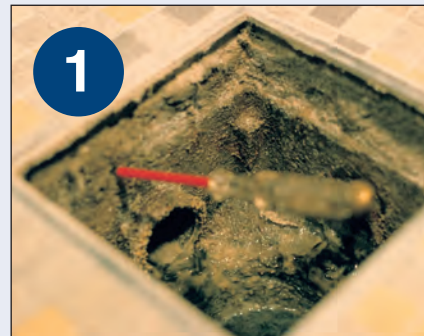
Eksempel på en tiltrængt renovering og hvor en nærmere undersøgelse viser, at der er huller i opstøbningen.
