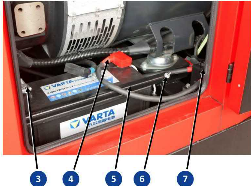
Kuva 10-1 Käynnistysakku (kuva vastaava)
