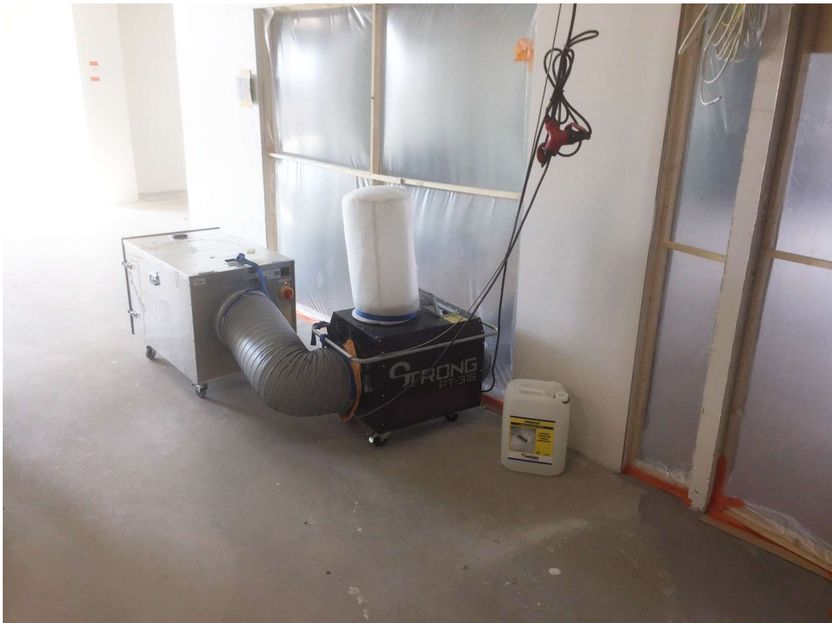
Esimerkkikuva rakennustyömaalta: Leikkaussalien väliaikainen ylipaineistus (ULS).
